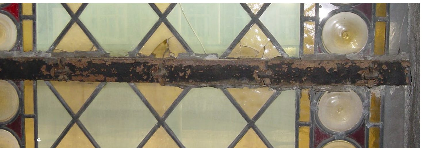
1. Gecorrodeerde vloerverwarmingsbuis 2. Schimmelvorming aan een altaar 3. Schimmelvorming aan een kerkorgel 4. Beschadigd glas-in-lood
