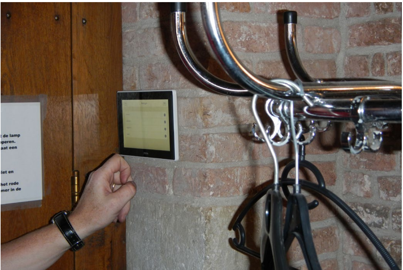
Bedieningspaneel van een gebouwbeheersysteem
