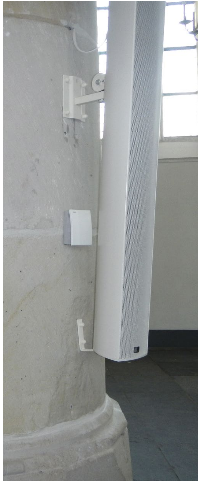
Thermostaat, gemonteerd aan een kolom, achter een speaker
